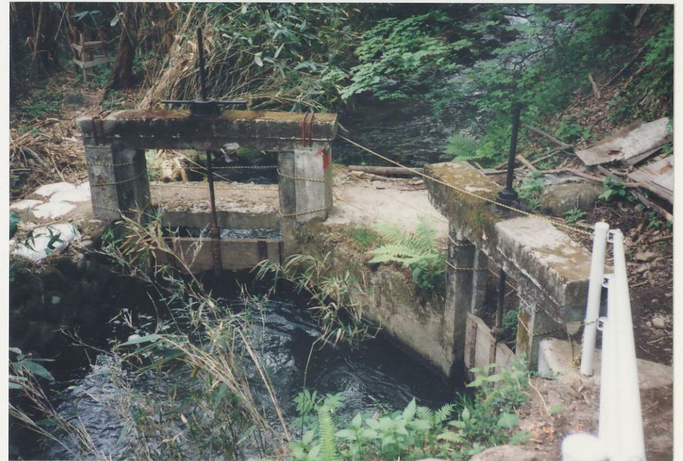
せきもと ③堰元の水門
