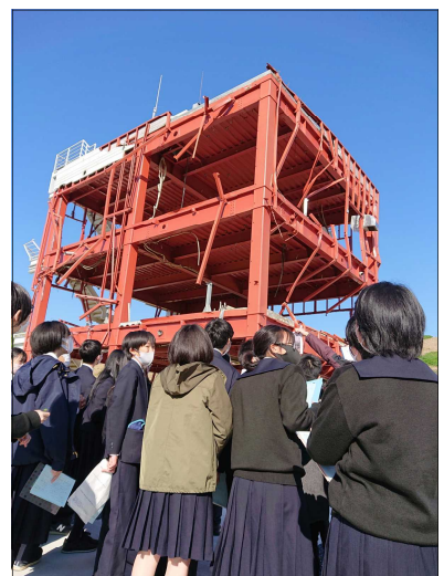
▲震災遺構「南三陸防災庁舎」むき出しの鉄筋が無残にも曲がっている
